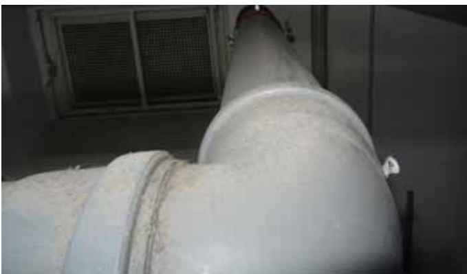
Rohre mit Staubauflage in Gemeinschaftswaschküche
