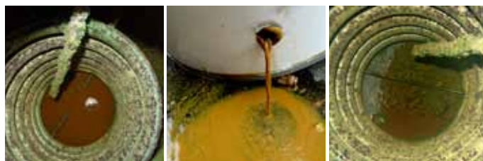
Abb. 6–8: Boiler: In diesem Zustand noch in Betrieb gewesen
